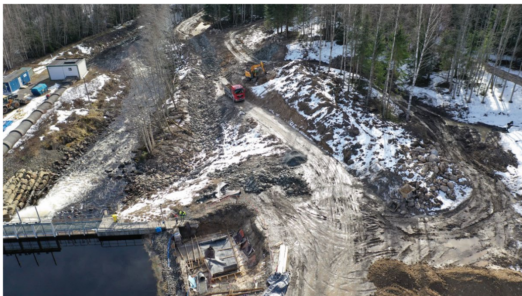
Figur 7. Pågående schakt och återfyllning av Rällsälvs faunapassage. Arbetet påbörjades längst nedströms i den "flödeskänsliga" delen för att snabbt komma bort från älvens flöde. Schakter och fyllningsarbeten rullade stegvis vidare uppströms längs faunapassagen
